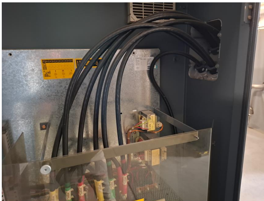
Attēls Nr.3 –Kabeļi
