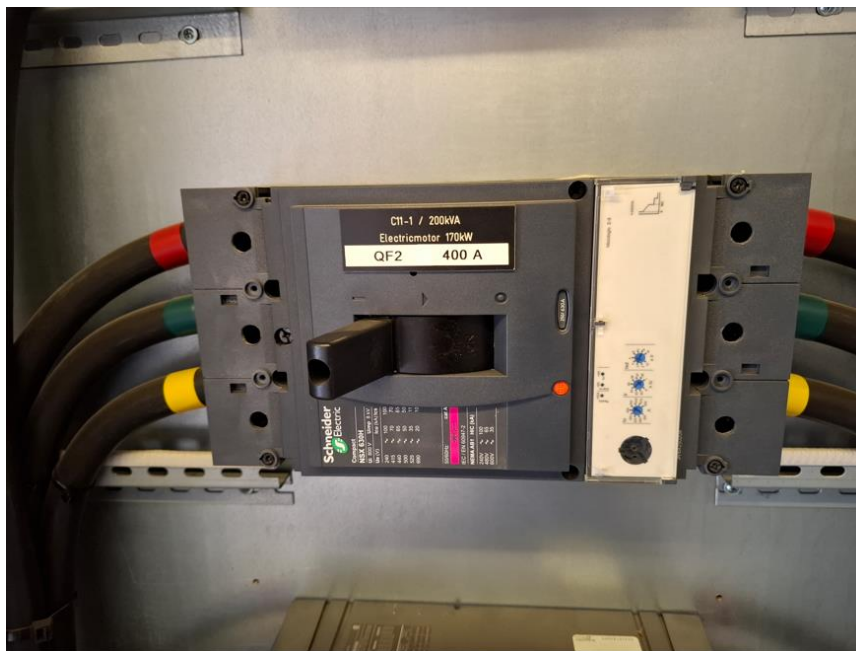
Attēls Nr.2 – Automātslēdzis un kabeļi
